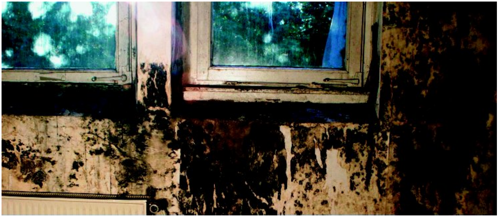
Eine verschimmelte Tapete muss entfernt werden.
