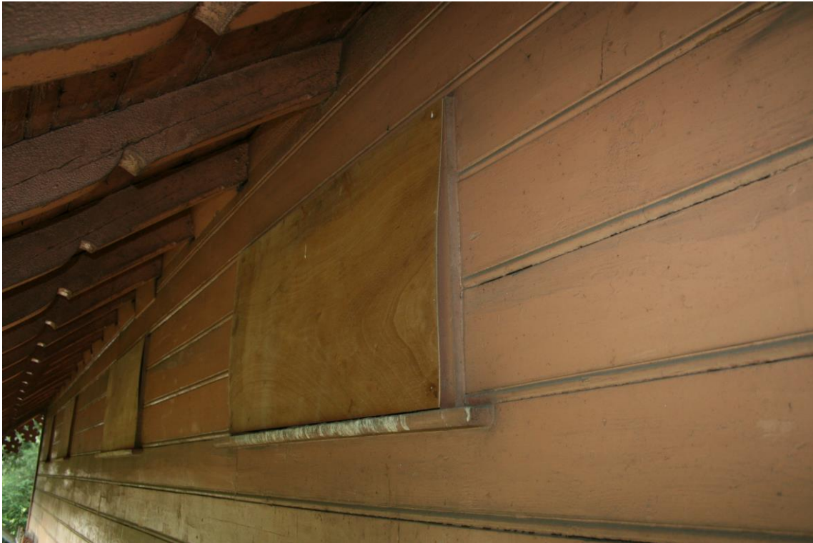
Westfassade (Gartenseite), 2.OG, Verschalung, vermutlich als Taubenschutz für die kleinen Fenster gedacht.
