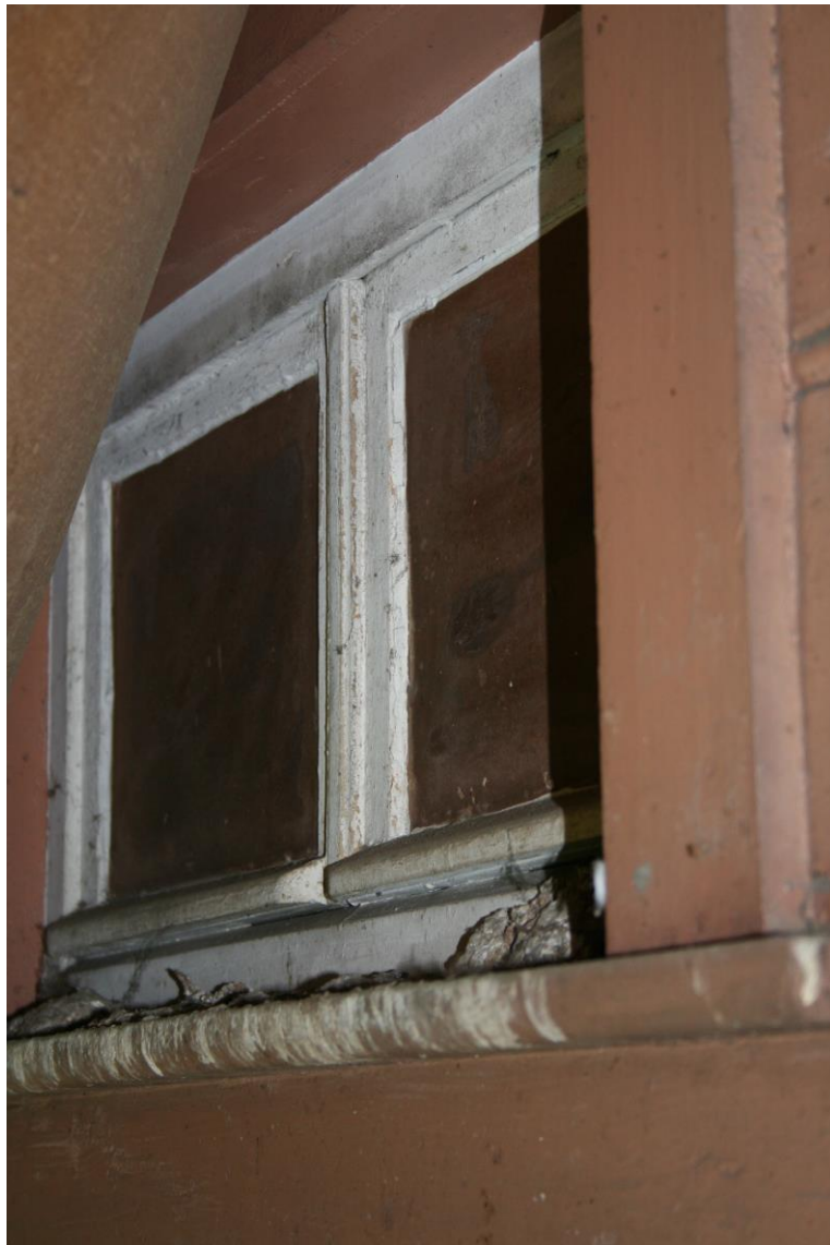
Westfassade (Gartenseite), 2.OG Kleines Fenster hinter der jüngeren Verschalung.
