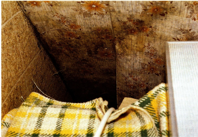
Schimmelpilzbildung durch Oberflächenkondensat hervorgerufen.
