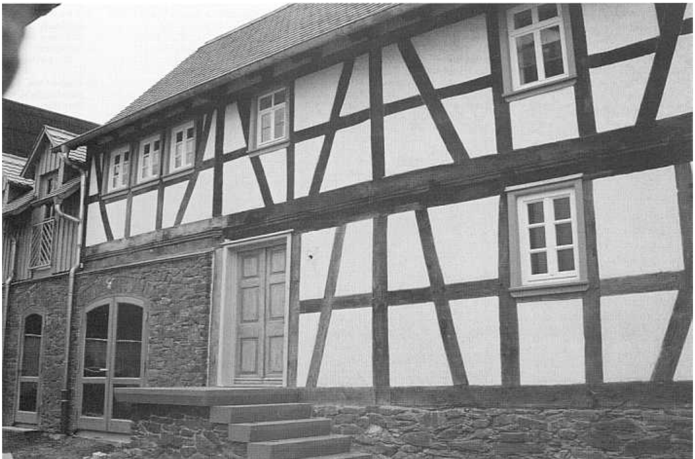
87 Niddatal-Ulfa, Haus Mittelstraße 19, Hoffassade nach der Sanierung, Foto Richter
